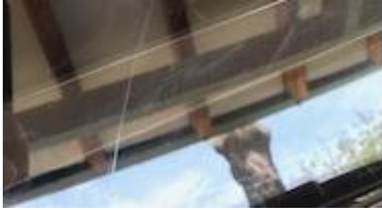
Figura 4: Desgaste superficial. Fuente: Autores
